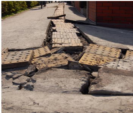
東日本大震災による埼玉県内の舗装版めくり上げ被害
